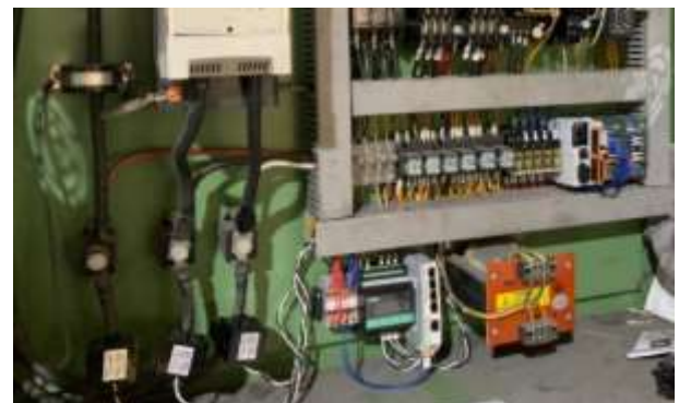
圖 15、智慧電錶安裝與通訊
